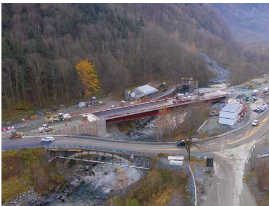
Le nouvel aménagement du pont de la Véna permet de sécuriser et de fluidifier le trafic dans une configuration beaucoup plus rectiligne.
