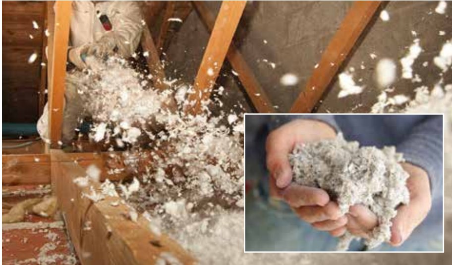
La technique de pose par soufflage sera privilégiée pour isoler les combles perdus des bâtiments publics, avec la projection de ouate de cellulose.
